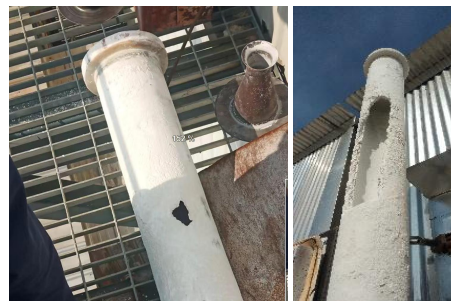
セラミックフィルターエレメント穿孔 原因：逆洗圧力または肉厚不均一、内壁強度不足です。
